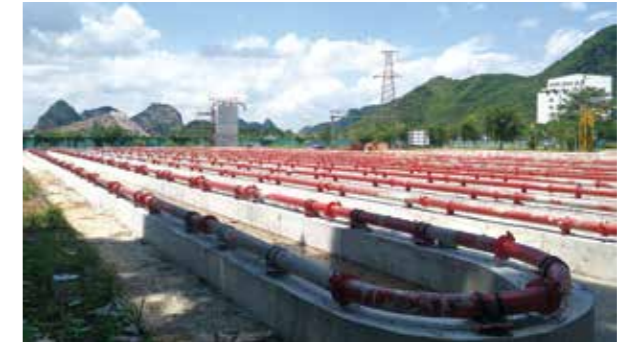
▲ “盘管试验平台”搭建现场
